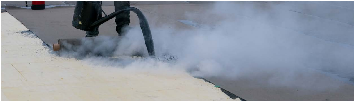
Liimausbitumi ei vaurioita eristeitä.
